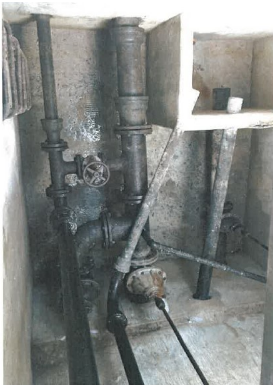
Appareillage : Vanne alimentation à gauche et incendie à droite. Conduite de refoulement à gauche, alimentation au centre, conduites des trop-plein et conduite de vidange avec vanne s'écoulant dans le bassin
