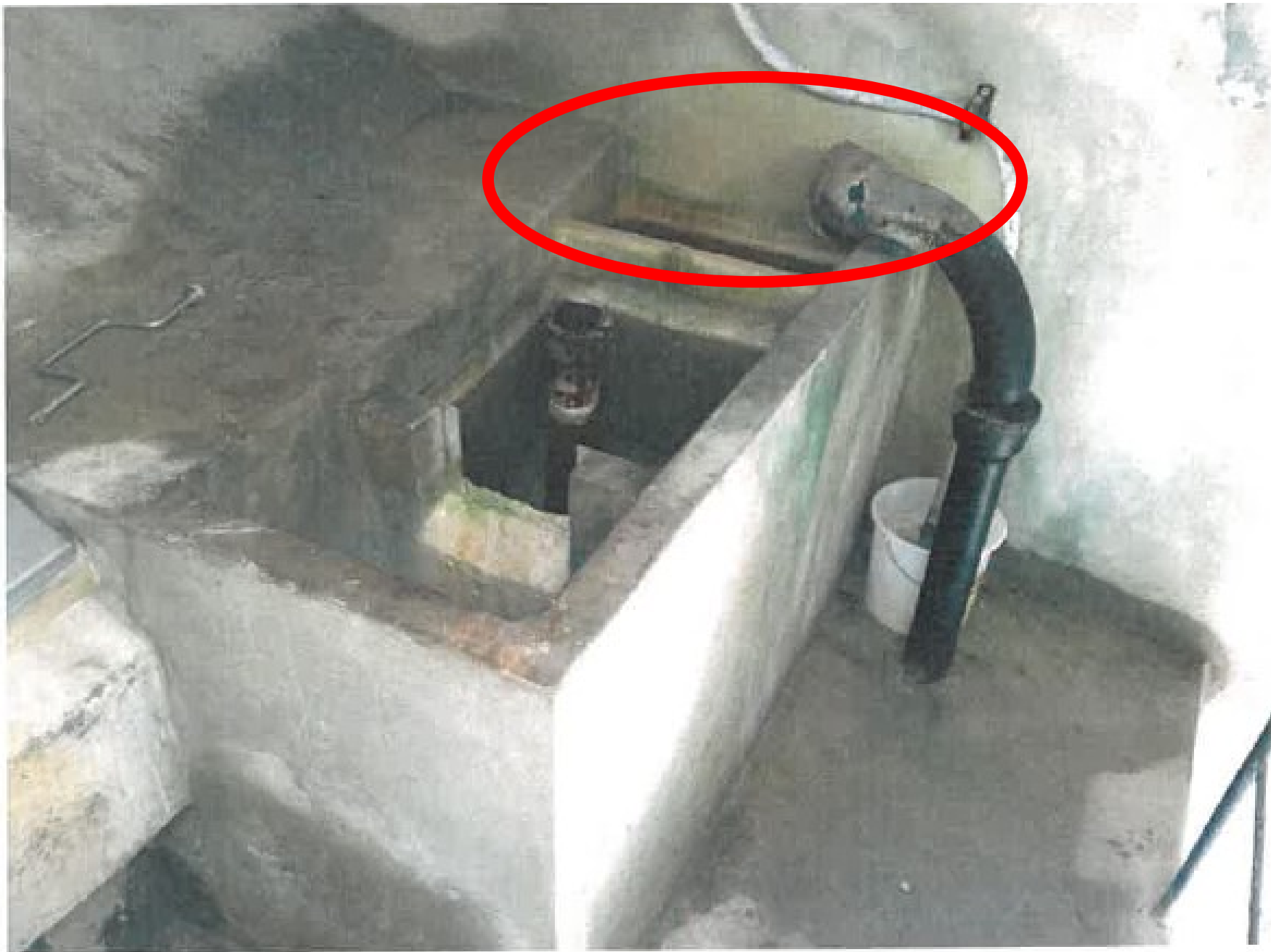
Bassin d'arrivée et de décantation des eaux du pompage
