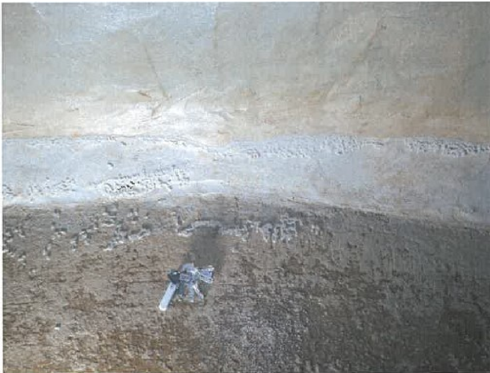
Pied de la paroi et sol de la cuve. Glaçage au mortier dépôts de calcaire
